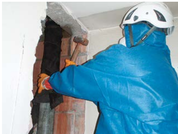
1 Qui un tubo in fibrocemento viene rotto in modo controllato con una mazza.
